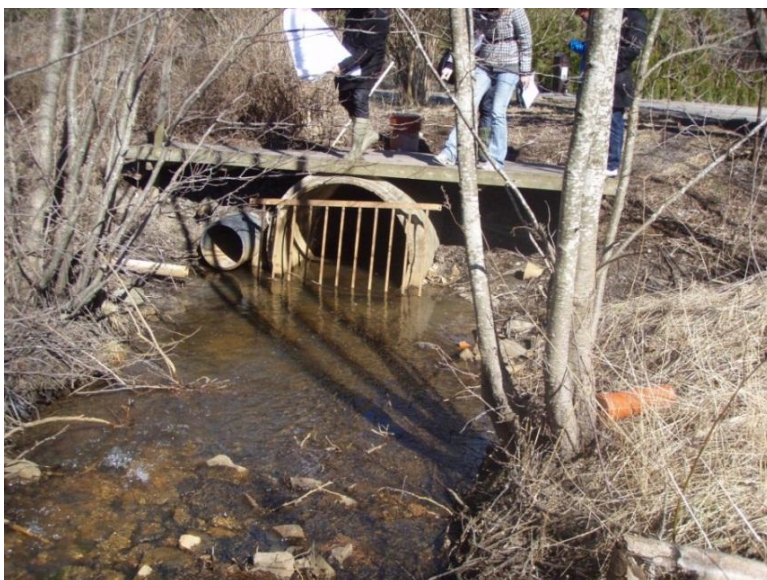
Figur 4:4. Utloppen från området vid Hallstens väg. Fotografi taget i samband med platsbesök 2012-04-04.
