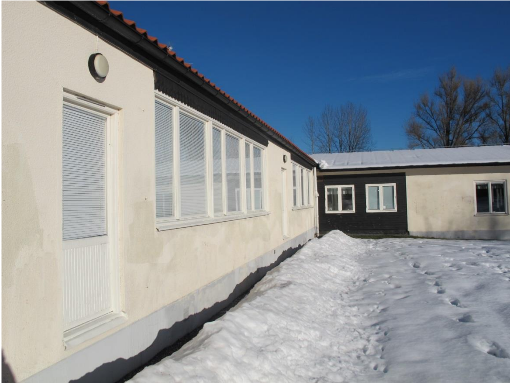
LP_2015_00036 Foto taget mot norr på den östra sidan. Här syns en relativt rik detaljeringsgrad i fasaddetaljerna.
