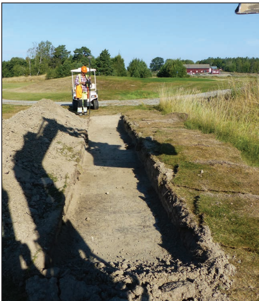
Fig. 1. Schakt 1 inom objekt 17. Flera av schakten grävdes inom golbanans greener där torven togs av och lades tillbaka med stor omsorg. Vid utredningsgrävningarna hade vi tillgång till en golfbil för att förflytta oss inom området. I bakgrunden anas ladugården vid Fors gård på norra sidan om motorväg 73. På bilden syns Karin Beckman-Thoor mäta in schaktet. Vy från sydost. Fotograf: Bitte Franzén.
