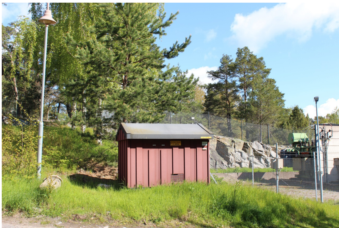
Transformatorstation som delvis står på fastigheten Vadet 3:240.
