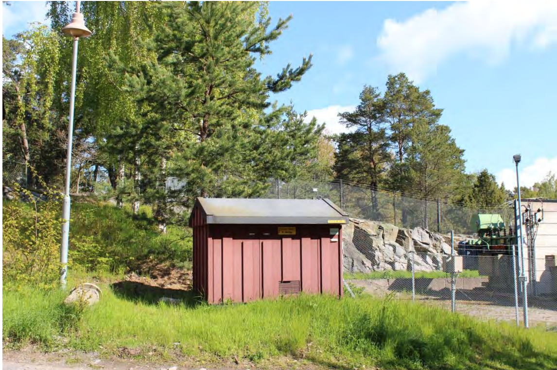
Transformatorstation som står delvis på fastigheten Vadet 3:240.
