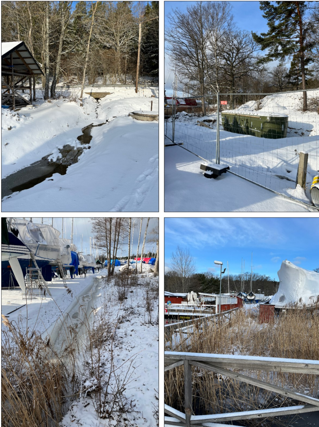
Figur 11. Övre bild till vänster visar en trumma under Dalarövägen 227. Övre bild till höger visar det nya reningsverket under byggnation. Nedre bild till vänster visar det stora diket som går centralt genom området. Nedre bild till höger visar det område som enligt översvämningsskartering ser instängt ut men som i själva verket är en del av recipienten.
