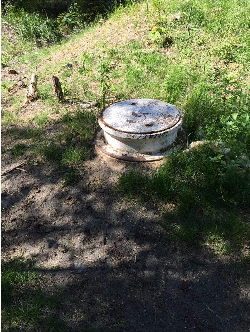
Bild 8. Brunn vid tågspåret som avger en påtaglig lukt av avlopp.
