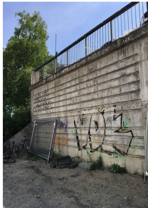
Bild 55 Klotter på betongmuren
