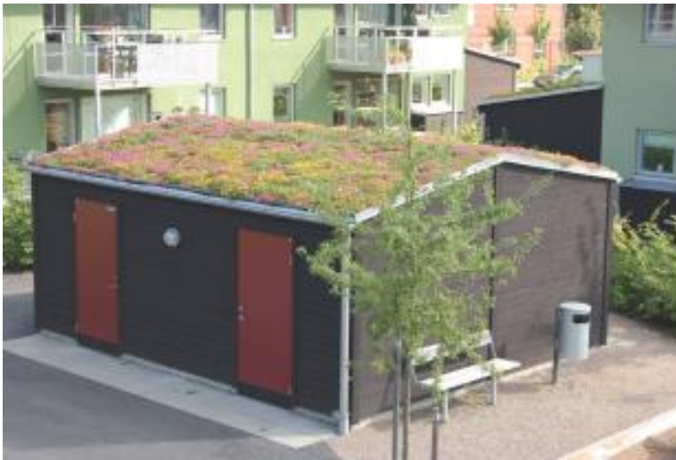
Figur 15. Exempel på grönt tak (bildkälla: vegtec.se)
