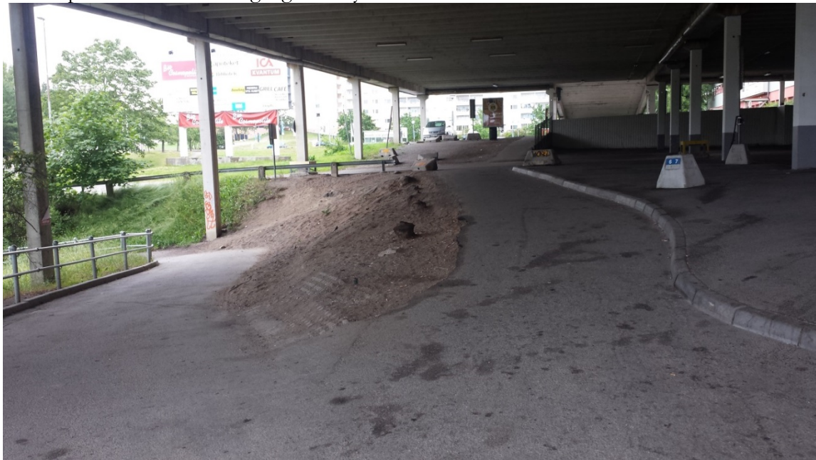
Gång- och cykelvägen går i en tunnel under Brandbergsleden för att komma upp under parkeringsdäcket där inlastningen till centrum finns. Foto: Karin Österdahl
