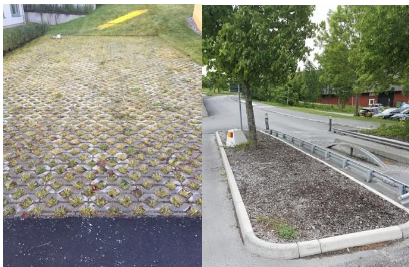
Figur 20. Foto till vänster: Gräsarmerad betong. Foto till höger: Genomsläpplig refug. (Geoveta, dagvattenutredning, 2017).
